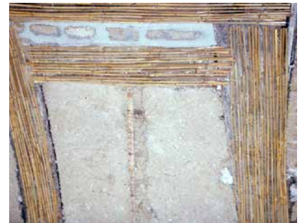
Tissu en roseau St70 sur poutres en bois dans une cloison en colombage.
